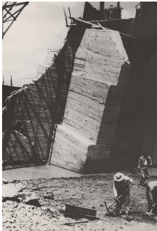
Abb. 4: Hochwasserschäden an den Anschlussfangedämme des zweiten Bauabschnittes an das linke Ufer.
