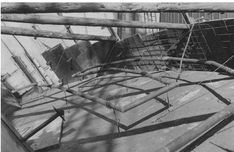
Abb. 7: Kühlschlange im Rundkopf
